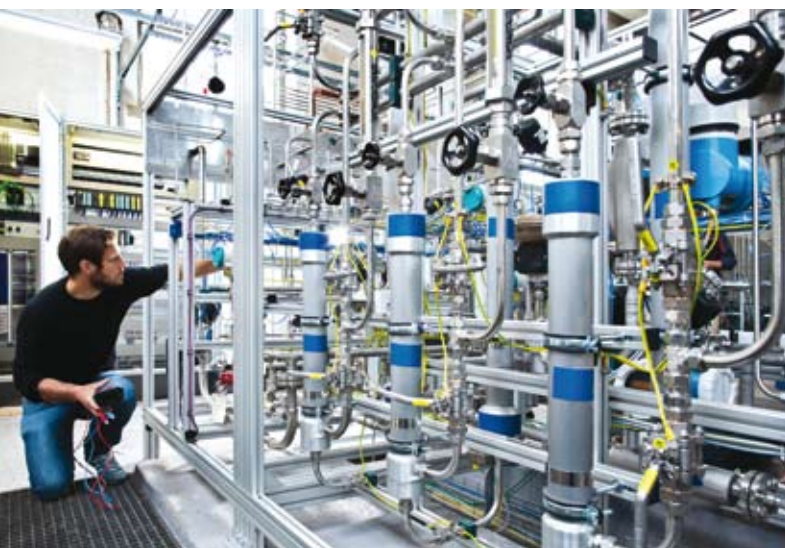
P2G®-Demo-Methanisierungsanlage des ZSW, Standort: Stuttgart, seit 2012 in Betrieb, Foto: ZSW
